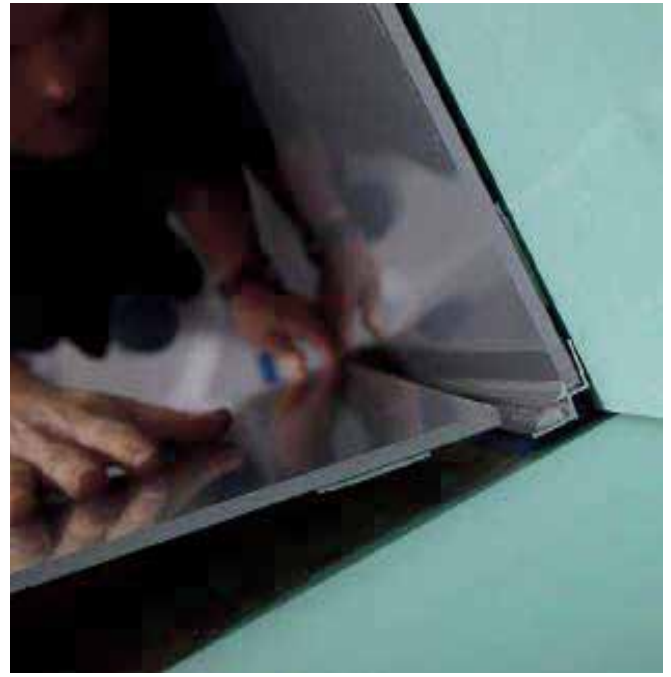
3.18 Beim Setzen der zweiten Platte wieder aus der Ecke beginnend anlegen und andrücken.
